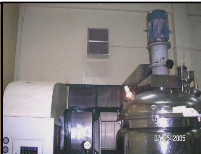
พัดลมระบายอากาศพร้อมแผ่นกรองอากาศ
